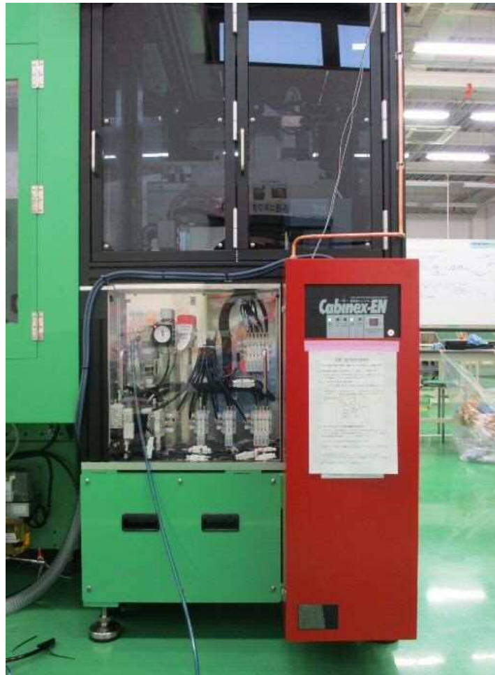
⑪自動消火装置
